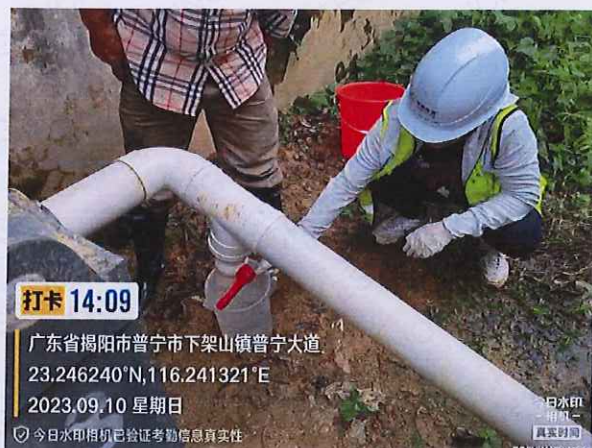
施工七标项目部厨房生活污水
